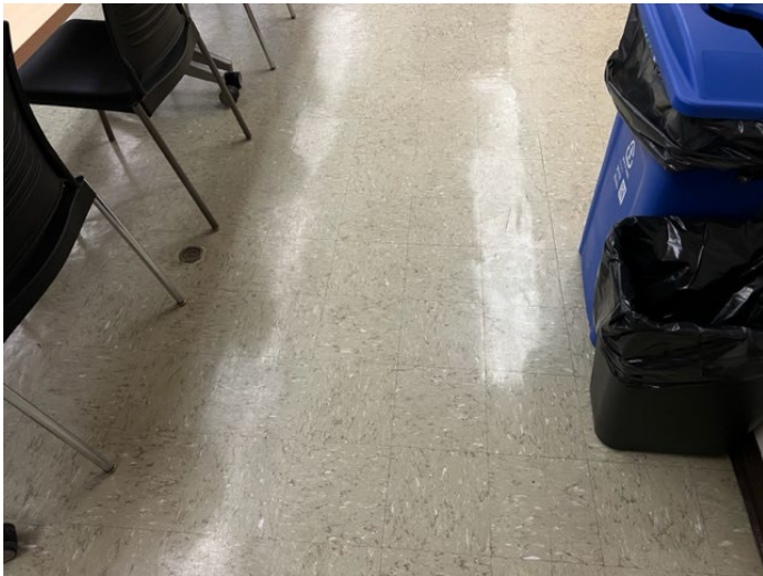
9" VFT Green & Mastic-Asbestos
